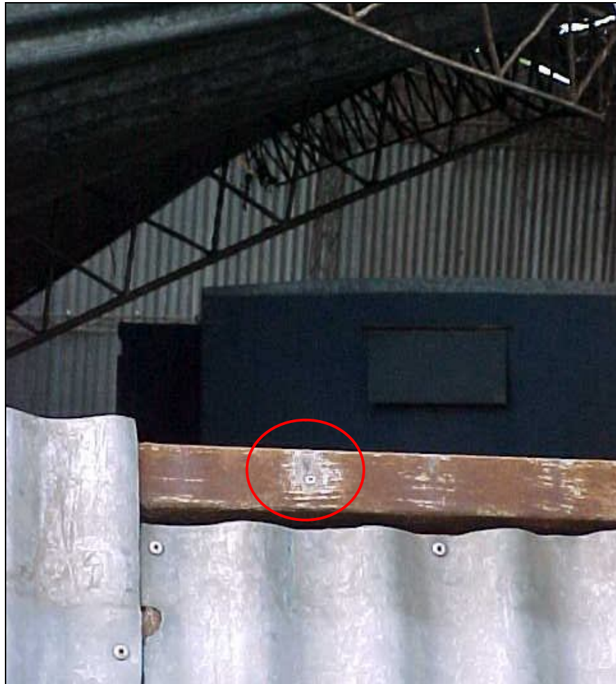
Figura 2-30: Detalle de Figura 2-29. Arrancamiento de chapas con fijaciones inadecuadas (remaches de aluminio tipo POP).
