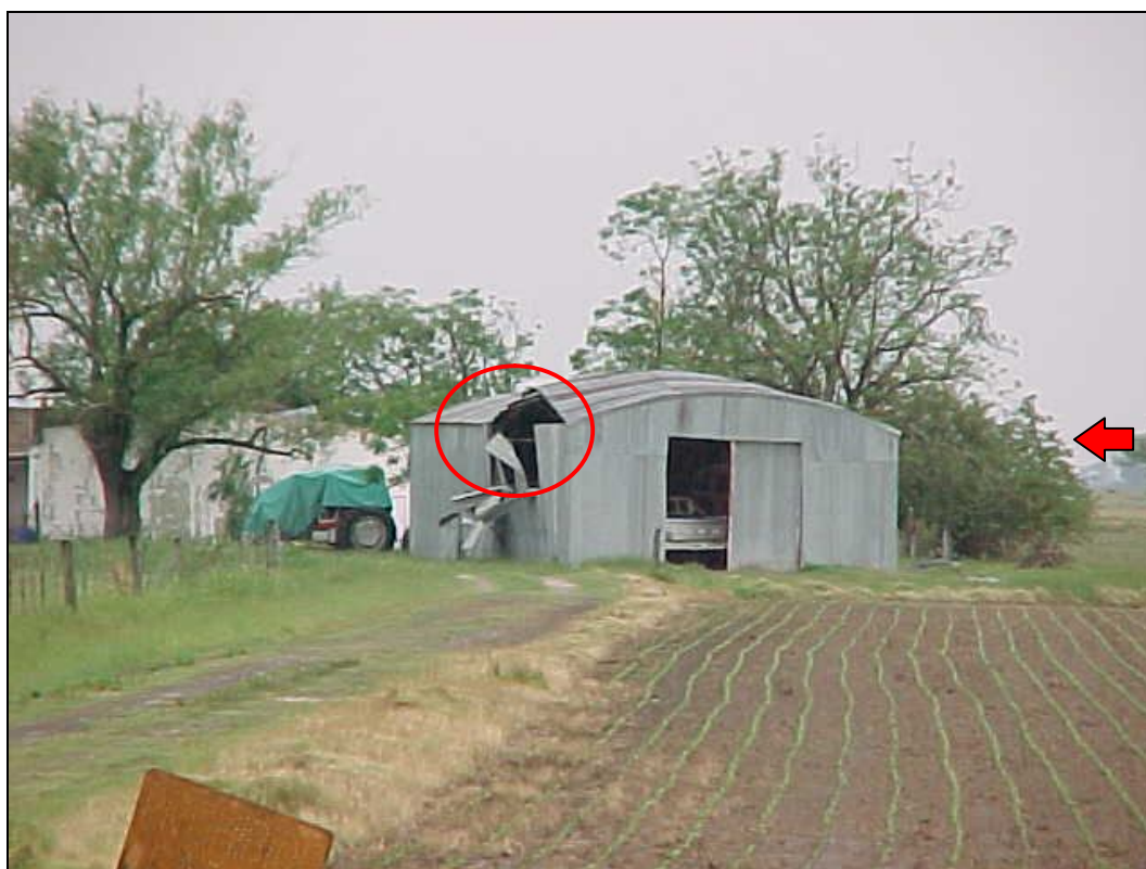
Figura 2-13: Arrancamiento de chapas y pandeo de correas (C&R), dirección del viento: oblicuo.
