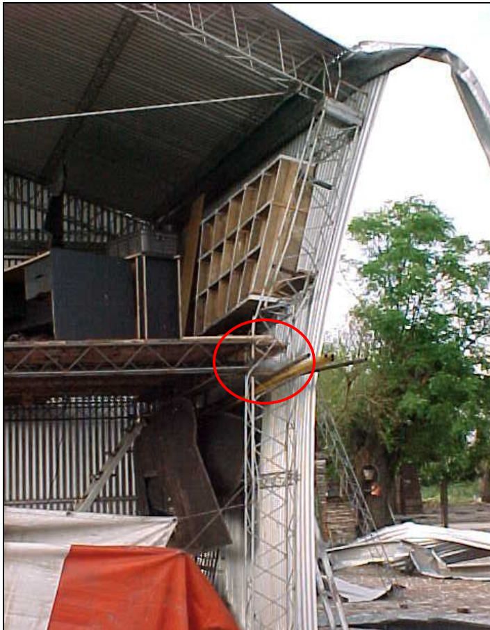
Figura 2-28: Pandeo localizado en columnas y arcos (SPRFV).
