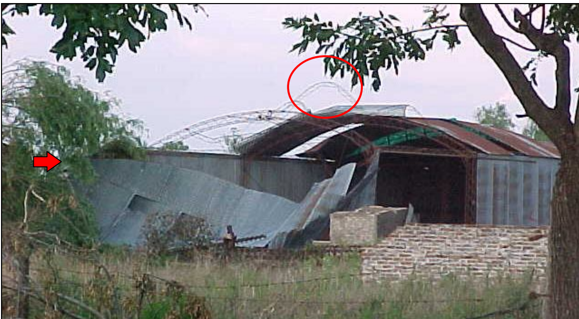
Figura 2-17: Pandeo general de las correas por empuje en el muro hastial a barlovento (SPRFV).
