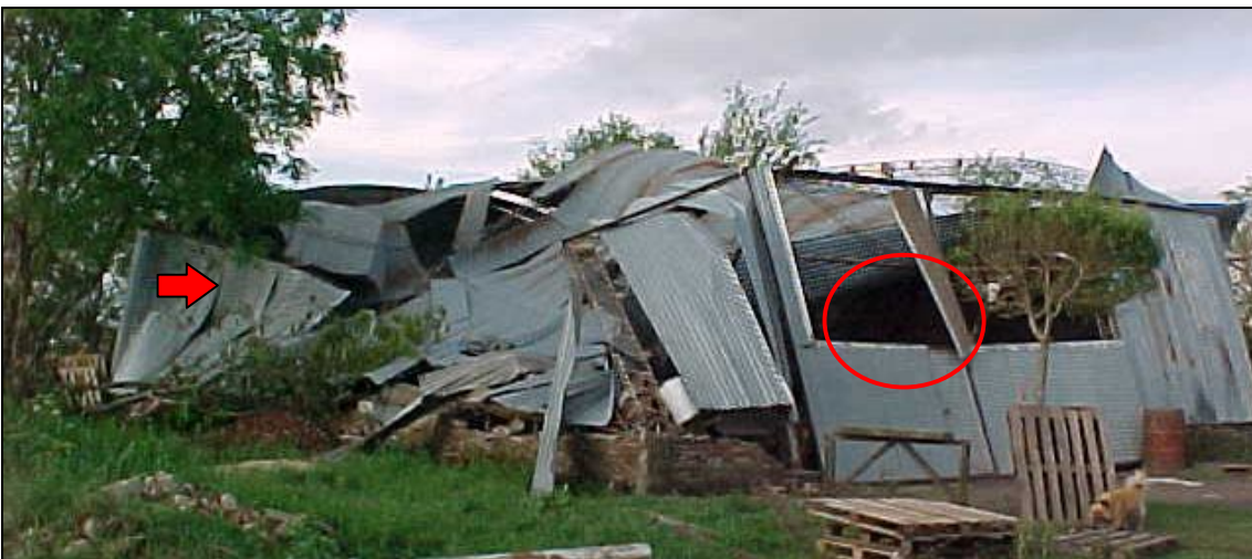
Figura 2-29: Falla de pórtico por esfuerzo horizontal en su plano. Falta de colaboración entre planos resistentes paralelos (SPRFV). Arrancamiento de chapas en zonas de succión (C&R).
