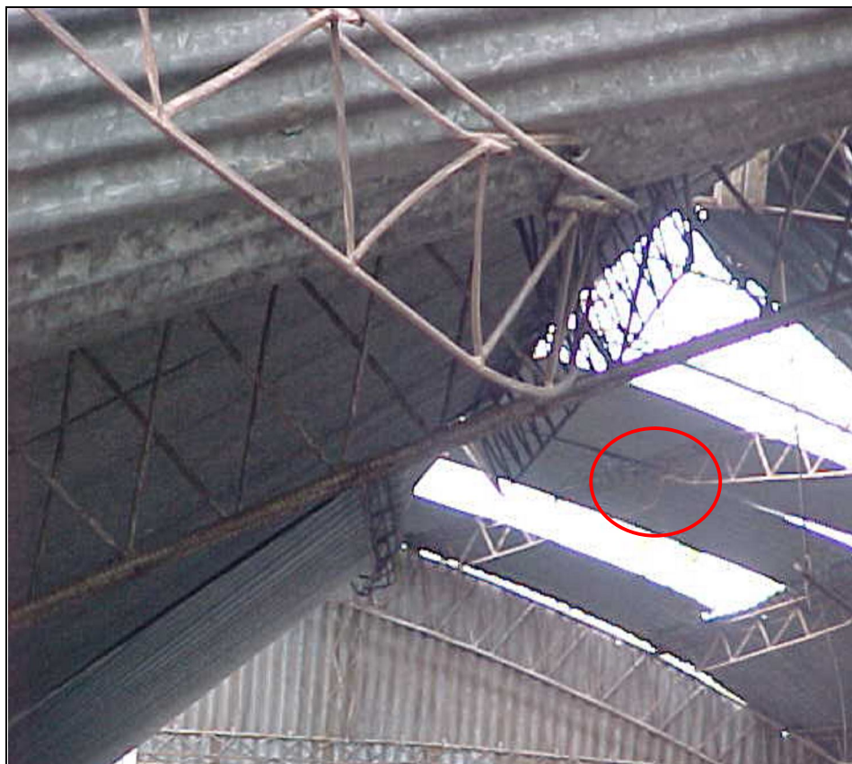
Figura 2-19: Pandeo de cordón comprimido en correa con sección "T" (C&R).
