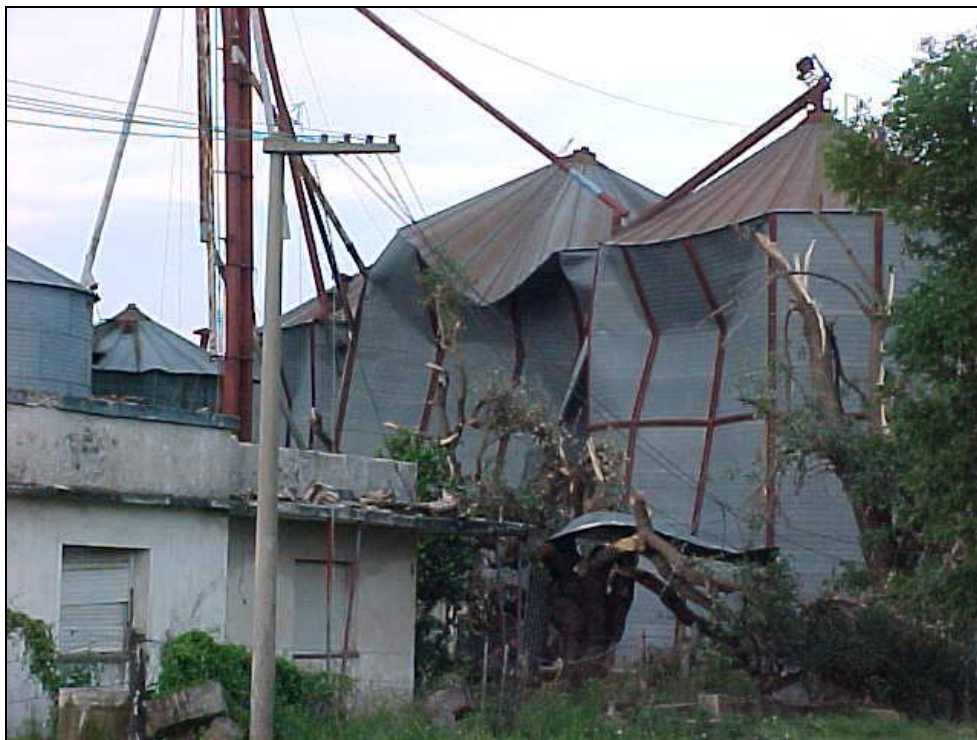
Figura 2-1: Silos de construcción metálica, dañados durante la tormenta estudiada.
