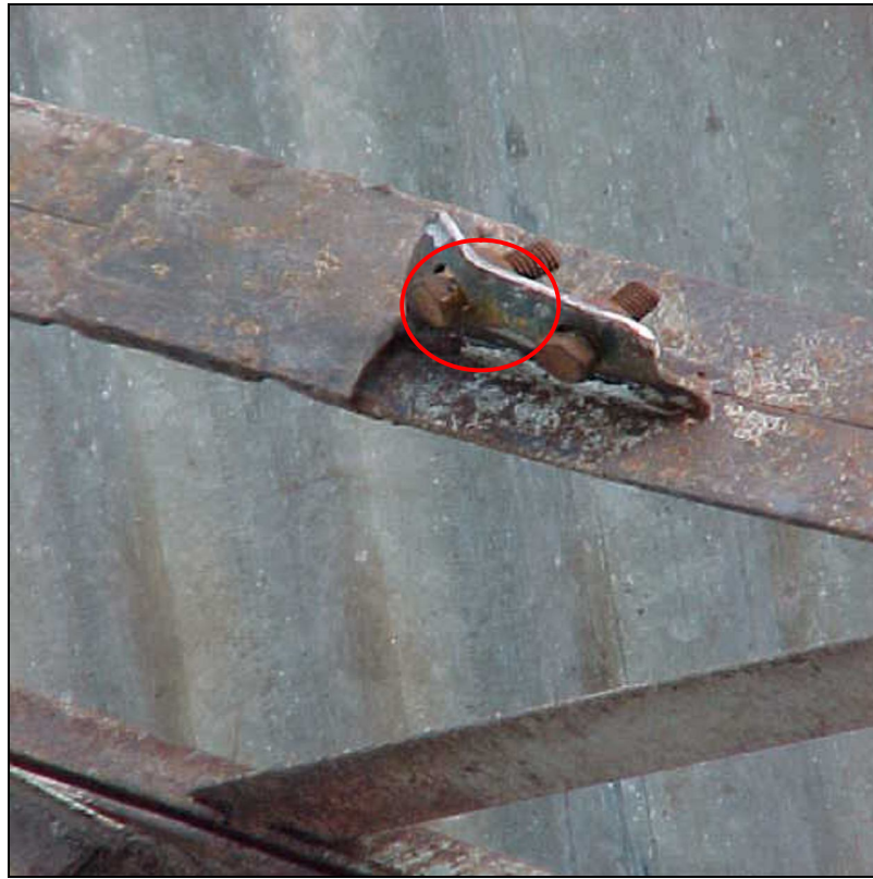
Figura 2-26: Falta de arandelas en uniones abulonadas.
