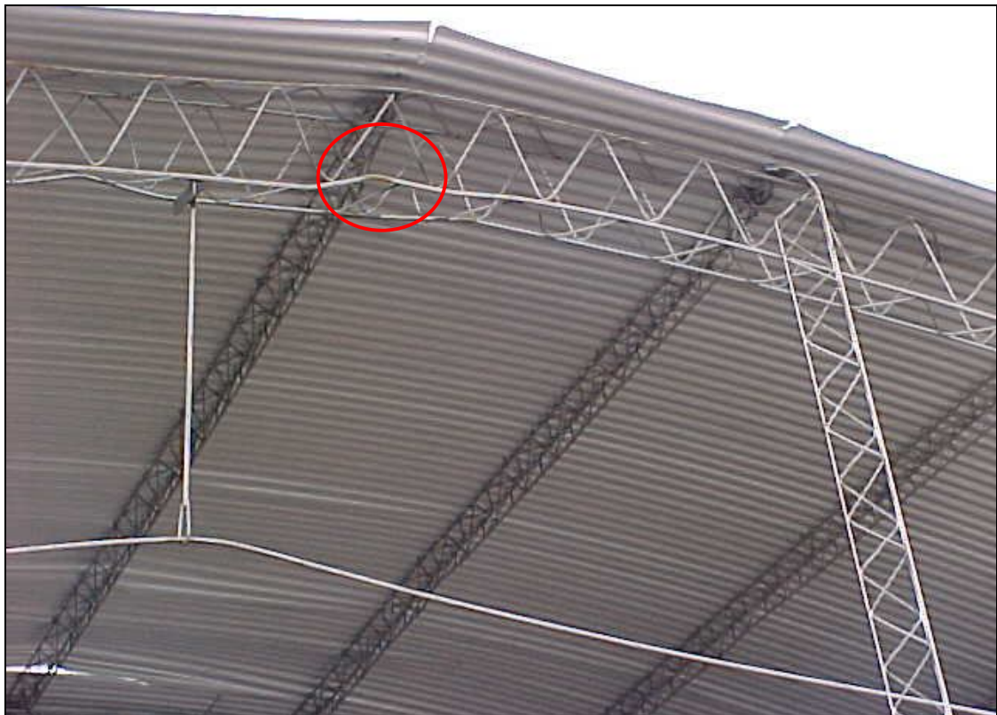
Figura 2-27: Falta de contraviento o contraviento inadecuado. Pandeo local del cordón comprimido del arco (SPRFV).
