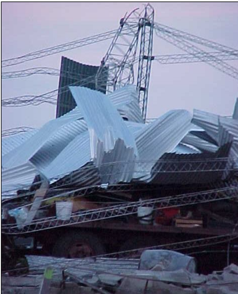
Figura 2-33: Voladura total de cubierta aislada. Detalle de Figura 2-32.
