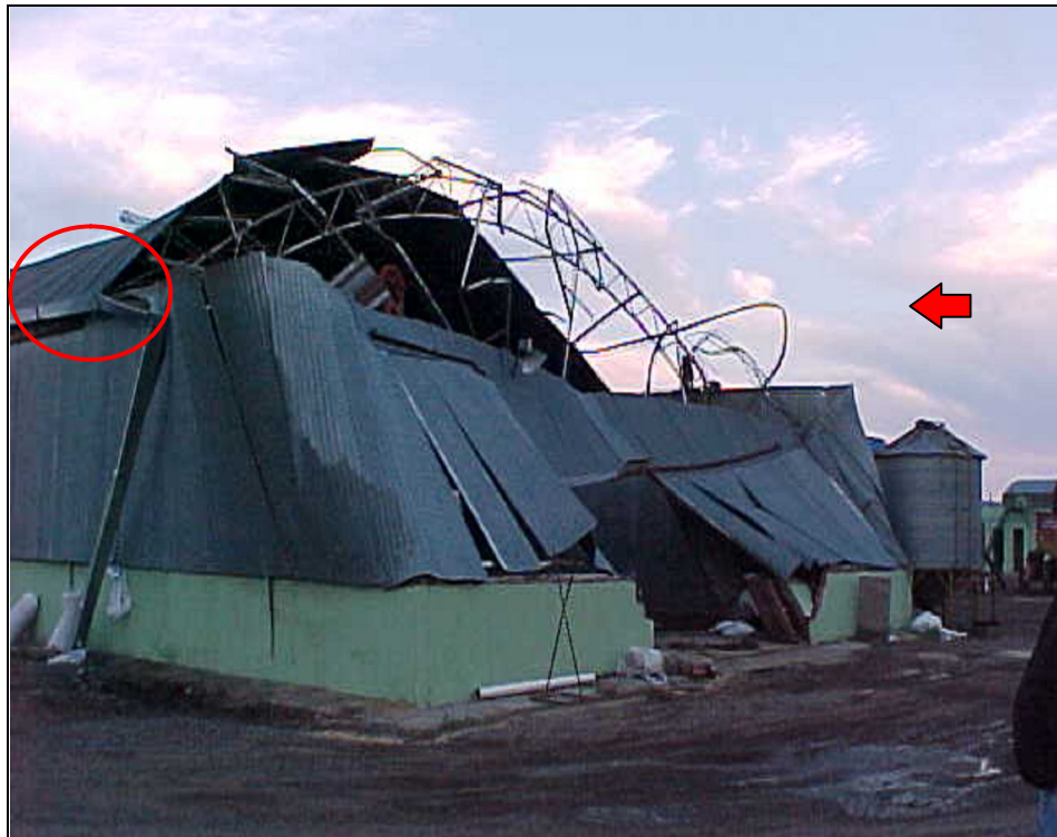
Figura 2-18: Pandeo general de las correas por empuje en el muro hastial a barlovento.
