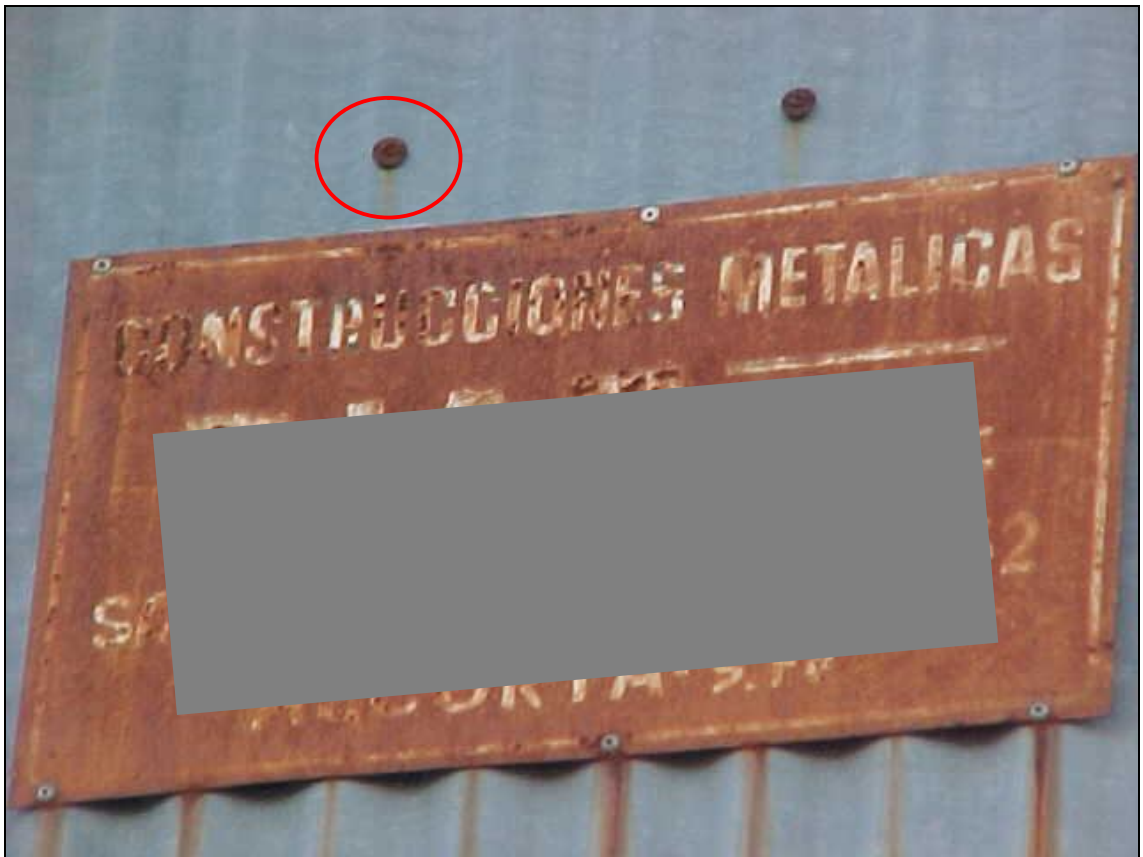
Figura 2-14: Fijación inadecuada de chapas (falta de arandelas).
