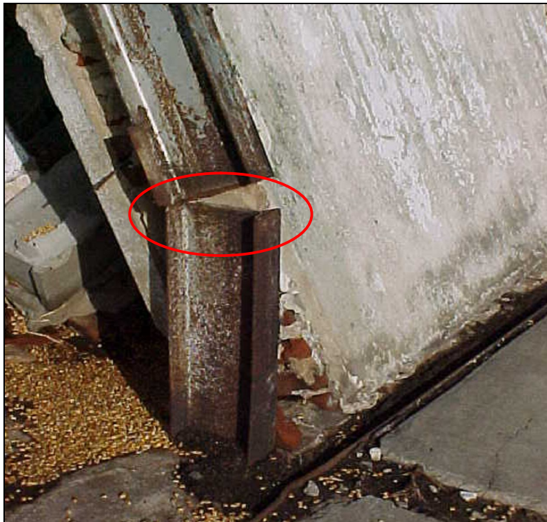
Figura 2-22: Falla de soldaduras en columna de pórtico, insuficiente penetración y ausencia de soldadura en alas del perfil (SPRFV).
