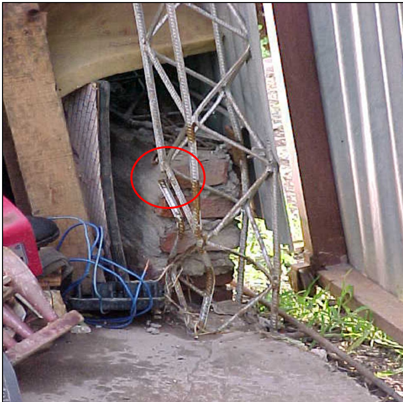
Figura 2-25: Falla en acero para hormigón armado soldado en columna de muro hastial (SPRFV).
