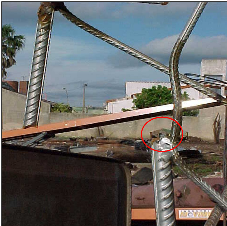
Figura 2-23: Falla en acero para hormigón armado soldado en columna de pórtico (SPRFV).
