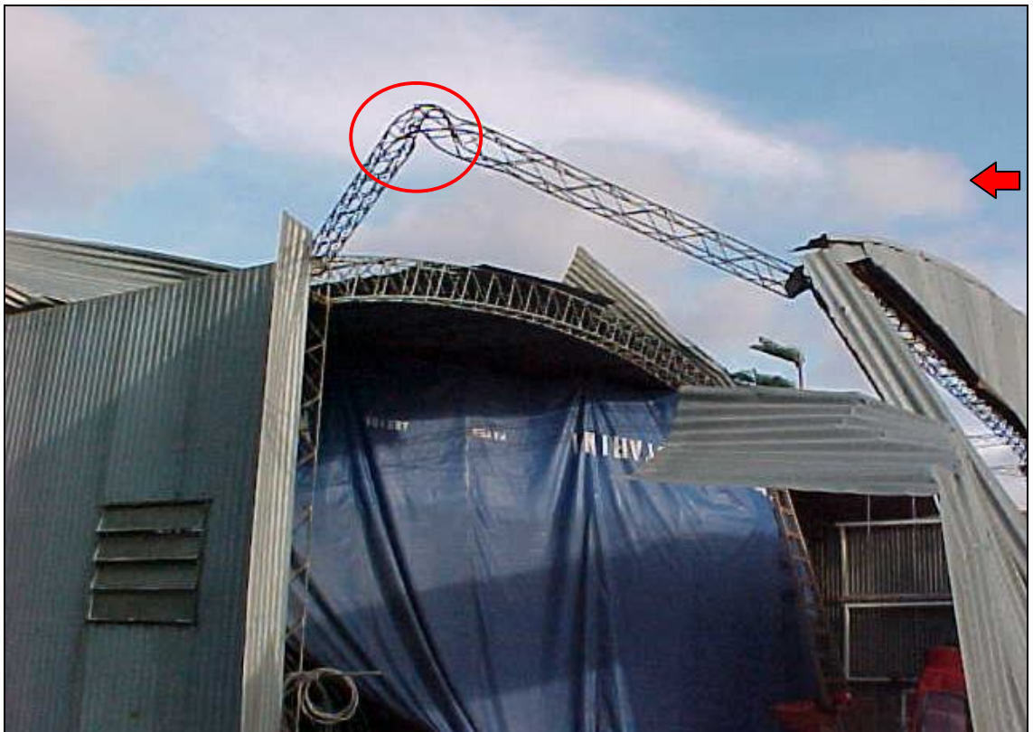
Figura 2-15: Pandeo general de las correas por empuje en el muro hastial a barlovento (SPRFV).
