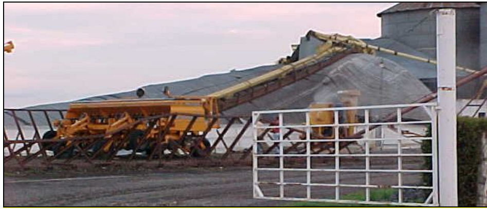
Figura 2-34: Voladura total de cubierta aislada. La estructura cubría un silo – celda que se encontraba vacío y no tenía paredes laterales. Se observan en primer plano las costillas del cerramiento temporal que se coloca cuando se llena.
