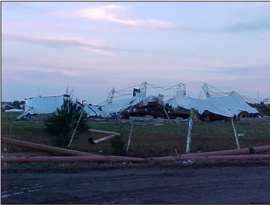
Figura 2-32: Voladura total de cubierta aislada.
