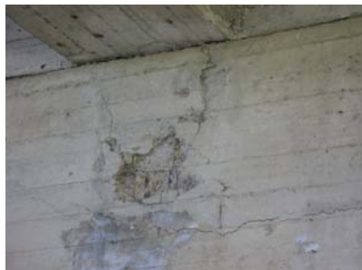
Figura 4: Deterioro en estribo N-O
