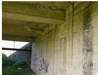
Figura 3: Deterioro en estribo N-O
