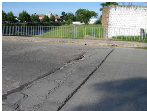
Figura 5: Fisuras sobre el tablero
