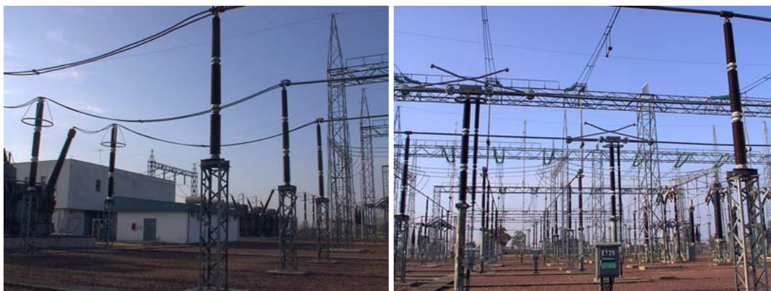
Figura 1.- Distintas vistas de la planta transformadora (zona analizada)
