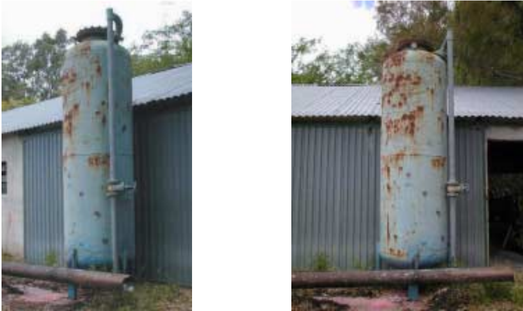
Figura 1: Tanque acumulador de aire comprimido
