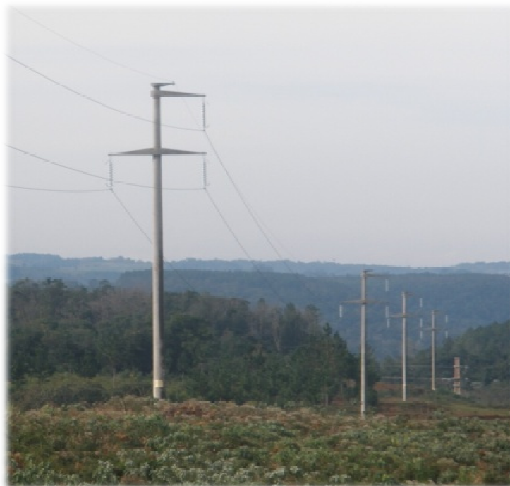
Figura 2: Estructuras de suspensión simple, línea de 132kV en simple terna. Típica, Misiones, Argentina
