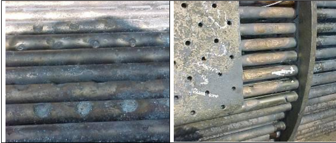
Figura 7: Daños en tubos y placa de choque. Izquierda: debajo de la placa de choque. Derecha: daño sobre la placa de choque y en su periferia
