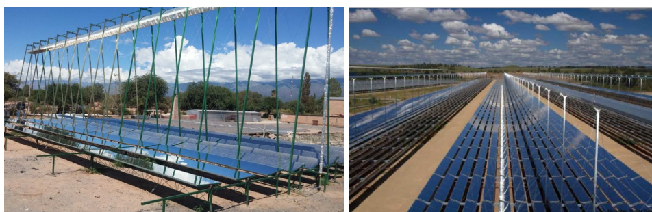
Figura 1: Izquierda: Prototipo de Fresnel Lineal del INENCO en la localidad de San Carlos, Salta ( Dellicompagni et al., 2016 ). Derecha: Planta Concentradora Fresnel Lineal en Liddell, Australia 1 .
