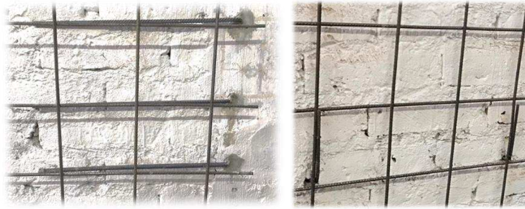
Figura 2 (b): Detalles de armado del MRAD (izq.: anclajes a los encadenados; der.: vinculación entre mallas).
