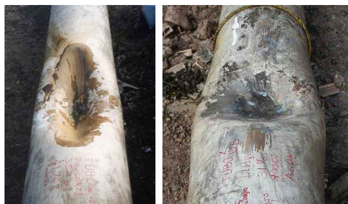
Figura 1. Fotografías de abolladuras generadas sobre tuberías de 24in API 5L X65 (tomado de Nieves 1 ).
