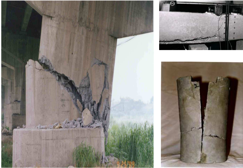
Figura 1.1: Fisuras en elementos de hormigón.
